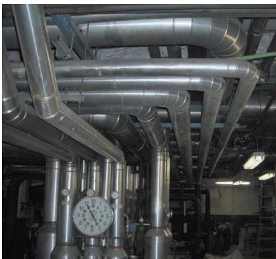
Figura 3. Fotografía de una sala de calderas de un hospital.
